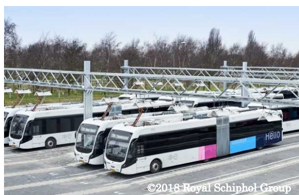
スキポール空港の充電施設
