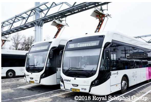
スキポール空港の充電施設
