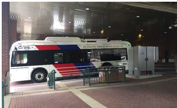
電気バスの200kW超急速非接触充電状況 （テネシー州チャタヌーガ）
