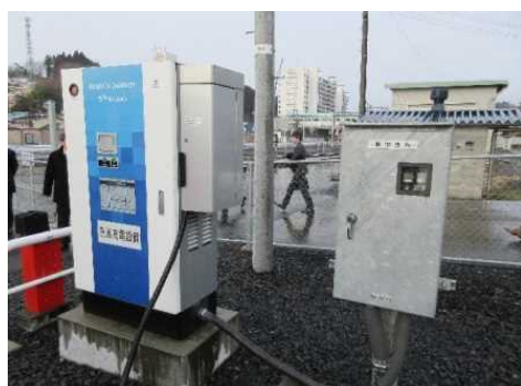
気仙沼 BRT 営業所への設置
